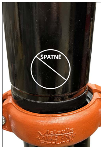
FOTOGRAFIE 2 (NEPŘIJATELNÉ) – POTRUBÍ UVOLNILO SPOJKU
