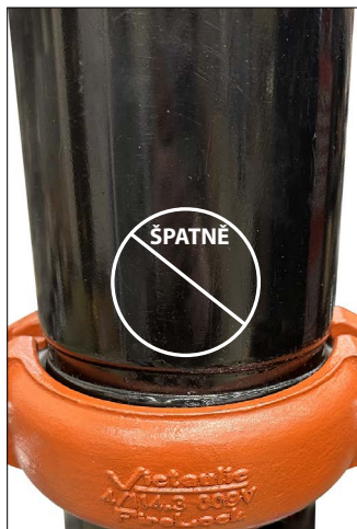
FOTOGRAFIE 3 (NEPŘIJATELNÉ) – PERA TĚLESA NEJSOU ZAROVNÁNA S DRÁŽKAMI TRUBKY
