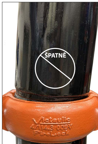
FOTOGRAFIE 1 (NEPŘIJATELNÉ) – NADMĚRNÝ ÚHEL ZASUNUTÍ
