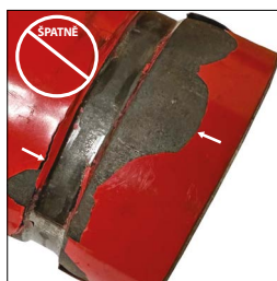
ŠPATNÝ KONEC TRUBKY OBSAHUJE SILNĚ ODŠTÍPNUTÝ NÁTĚR NA ROZMĚRU „A“
