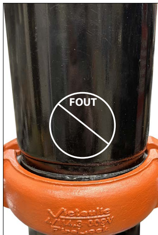
FOTO 3 (ONACCEPTEBEL) – DE SPIEËN VAN DE BEHUIZINGEN LIGGEN NIET IN LIJN ET DE GROEVEN VAN DE LEIDING
