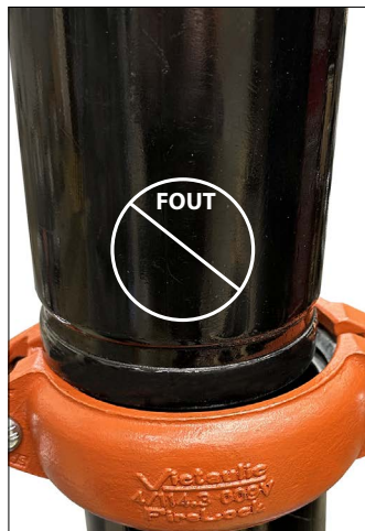
FOTO 2 (ONACCEPTEBEL) – DE KOPPELING VAN DE LEIDING IS LOSGEKOMEN
