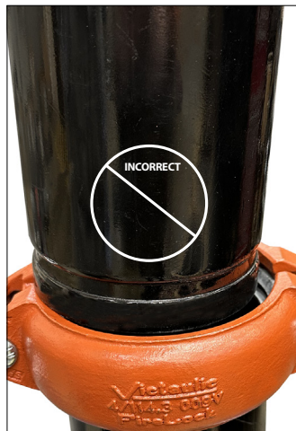
PHOTO 2 (INACCEPTABLE) – TUYAU AVEC COLLIERS DÉTACHÉS
