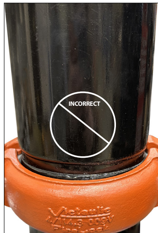
PHOTO 3 (INACCEPTABLE) – TALONS DU SEGMENT NON ALIGNÉS AVEC LES RAINURES DU TUYAU
