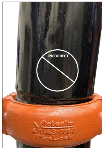
PHOTO 1 (INACCEPTABLE) – ANGLE D'INSERTION EXCESSIF
