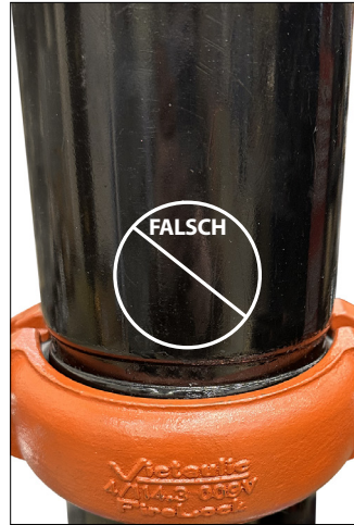
FOTO 3 (UNZULÄSSIG) – GEHÄUSEKEILE SIND NICHT AUF DIE ROHRNUTEN AUSGERICHTET
