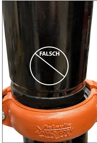
FOTO 2 (UNZULÄSSIG) – ROHR MIT GELÖSTER KUPPLUNG
