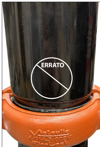
FOTO 3 (INACCETTABILE) – CHIAVETTE DEGLI ALLOGGIAMENTI NON ALLINEATE CON LE SCANALATURE DEL TUBO
