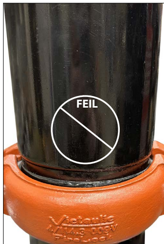
BILDE 3 (UAKSEPTABELT) – KNOTTENE I HUSET ER IKKE PÅ LINJE MED SPORENE I RØRET
