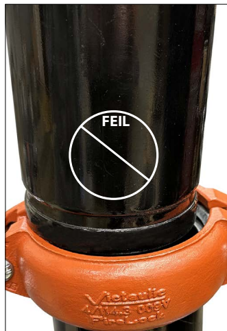
BILDE 2 (UAKSEPTABELT) – RØRET HAR LØSNET KOBLINGEN
