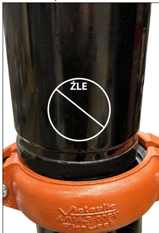
ZDJĘCIE 2 (NIEPRAWIDŁOWO) – NIEWŁAŚCIWIE UMIESZCZONY ŁĄCZNIK NA RURZE
