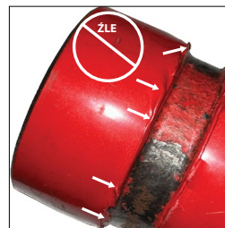
ŹŁE WYKONANY KONIEC RURY BĘDZIE POSIADAŁ POMARSZCZONĄ/POFAŁDOWANĄ WARSTWĘ FARBY WIDOCZNĄ W OBSZARZE „A”
