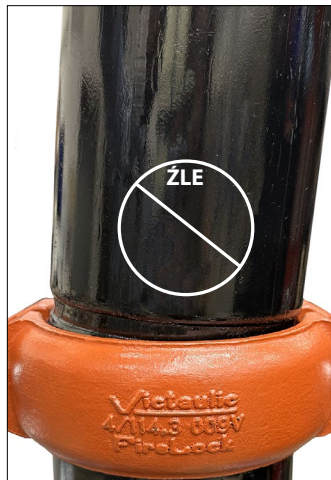
ZDJĘCIE 1 (NIEPRAWIDŁOWO) – ZBYT DUŻY KĄT OSADZENIA
