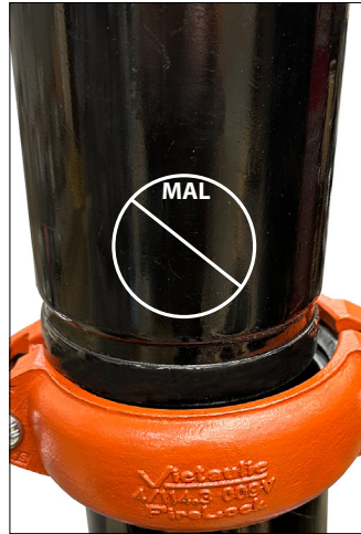
FOTO 2 (INACEPTABLE) – LA TUBERÍA SE SALIÓ DEL ACOPLE
