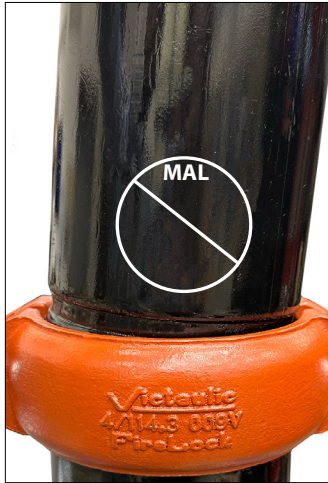
FOTO 1 (INACEPTABLE) – ÁNGULO DE INSERCIÓN EXCESIVO
