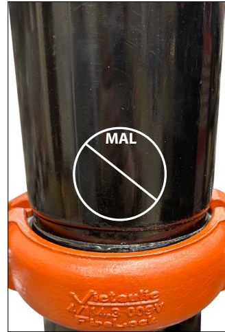
FOTO 3 (INACEPTABLE) – LAS CUÑAS DE LOS SEGMENTOS NO ESTÁN ALINEADAS CON LAS RANURAS DE LA TUBERÍA
