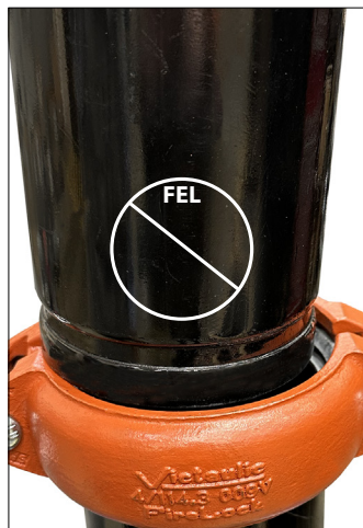
FOTO 2 (EJ ACCEPTABELT) – RÖRET HAR EN RUBBAD KOPPLING
