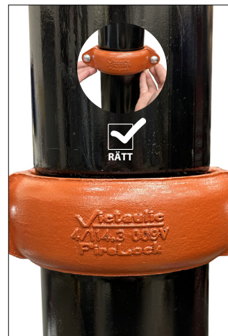
FOTO 4 (ACCEPTABELT) – HUSETS SPÅR ÄR INPASSADE MED RÖRETS RILLOR
