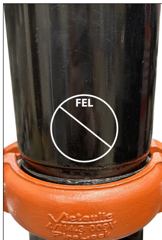
FOTO 3 (EJ ACCEPTABELT) – HUSETS SPÅR ÄR INTE INPASSADE MED RÖRETS RILLOR
