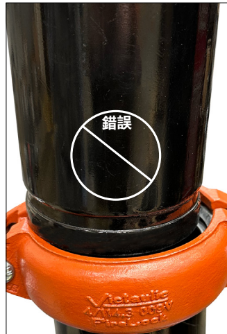
照片2 (不合格) - 管道已脫開卡箍
