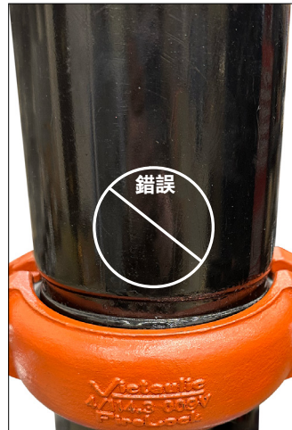
照片3 (不合格) - 外殼鍵未與管槽對齊
