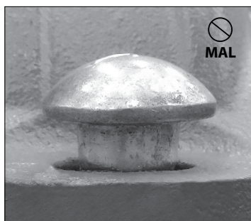
INSERCIÓN INCORRECTA DE LOS PERNOS (CUELLO OVAL NO ASENTADO ADECUADAMENTE EN EL ORIFICIO DEL PERNO)
