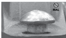
INSERCIÓN INCORRECTA DEL PERNO (EL CUELLO OVAL DEL PERNO NO SE ASIENTA ADECUADAMENTE EN EL ORIFICIO DEL PERNO)
