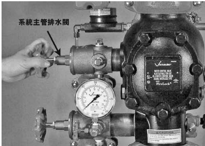
8. 打開系統主管排水閥，排出所有積水，並釋放系統氣壓。
