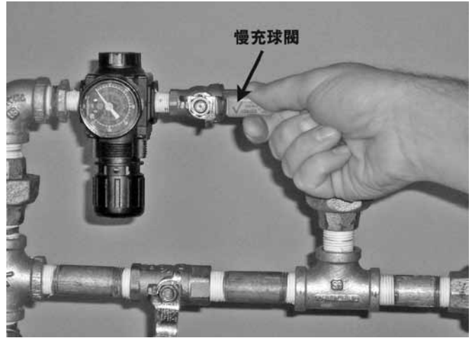
11. 對於氣動(乾式先導)釋放系統:開啟AMTA上的慢充球閥。
