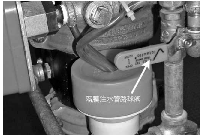
9. 关闭隔膜注水管路球阀。
