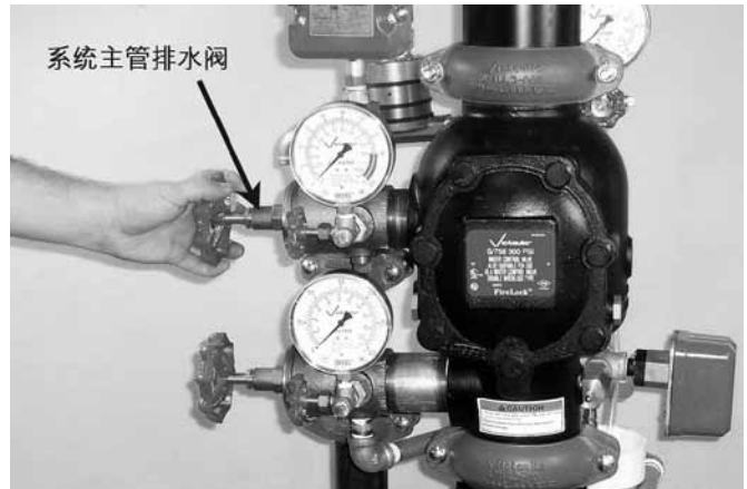
8. 关闭系统主管排水阀。
