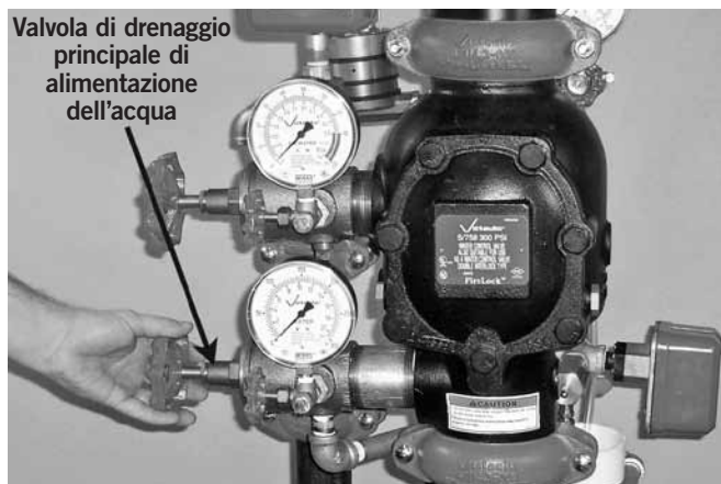
17. Quando il flusso dell'acqua è costante, chiudere la valvola di drenaggio principale di erogazione dell'acqua.
