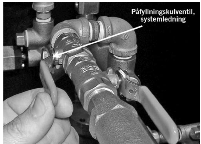
10. Sätt kulventilen på systempåfyllningsledningen i läget "ÖPPEN – SNABB PÅFYLLNING". Återställ trycket till normalt systemtryck igen.
