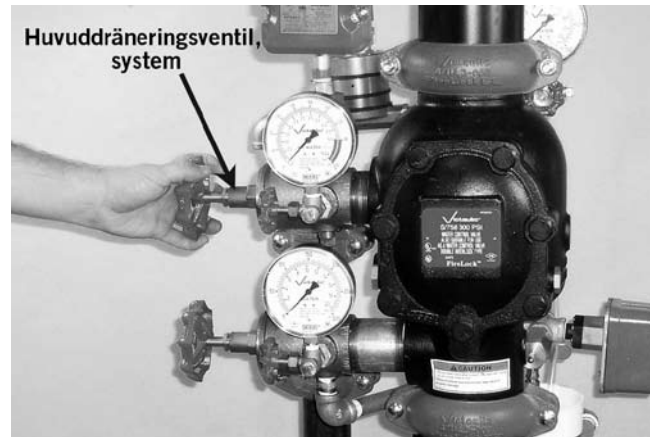
8. Stäng systemets huvuddräneringsventil.
