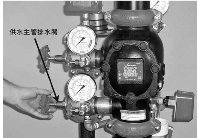
14. 打開供水主管排水閥。
