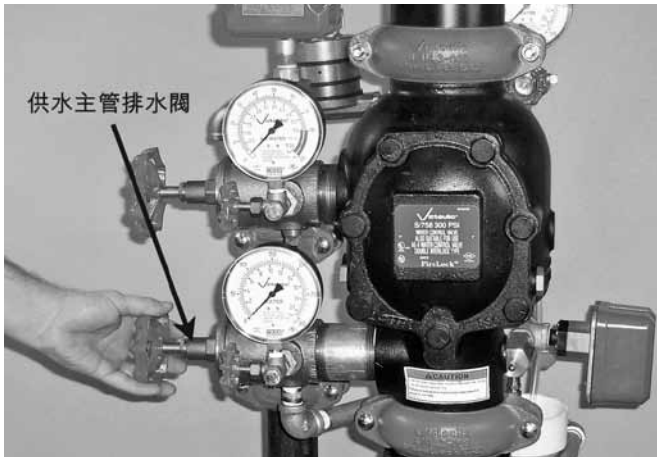
25. 打開供水主管排水閥。
