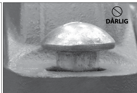
DÅRLIG BOLTFFESTE (DEN OVALE HALSEN SITTER IKKE RIKTIG I BOLTHULLET)
