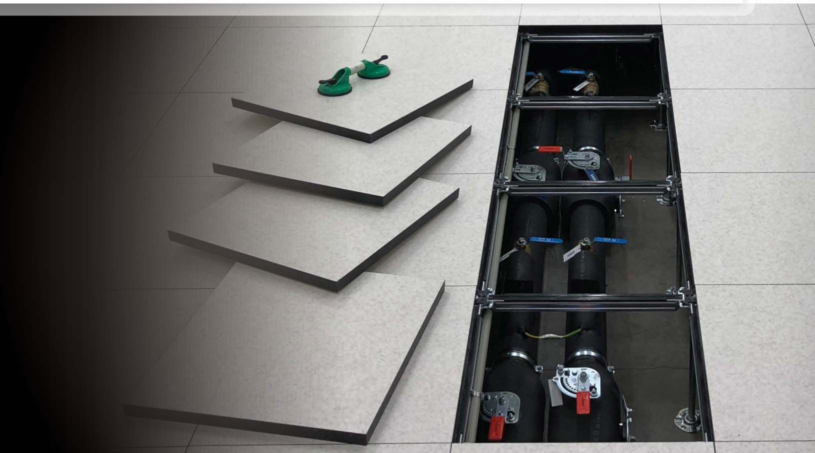
Les produits Victaulic ont permis l'installation d'un système de refroidissement liquide de 45 kW dans une salle d'équipements de TI climatisée.
